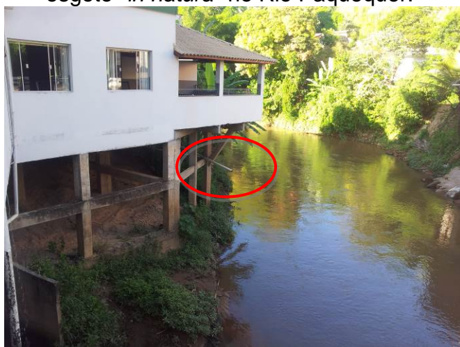
Figura 16 – Exemplo de Lançamento de esgoto " in natura " no Rio Paquequer.
