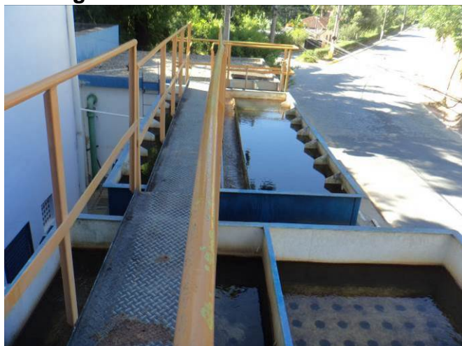
Figura 6 – Floculador e Decantador.
