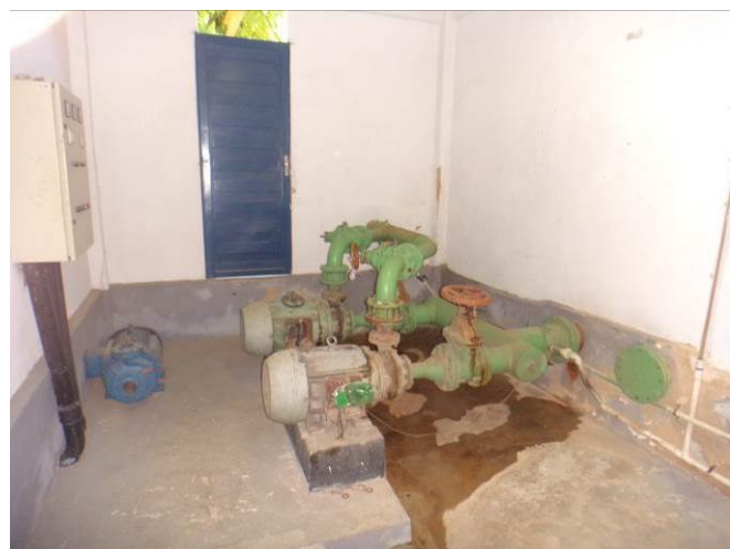
Figura 9 – Casa de Bombas.
