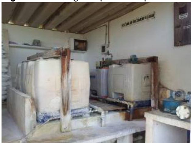
Figura 12 – Abrigo de produtos químicos.
