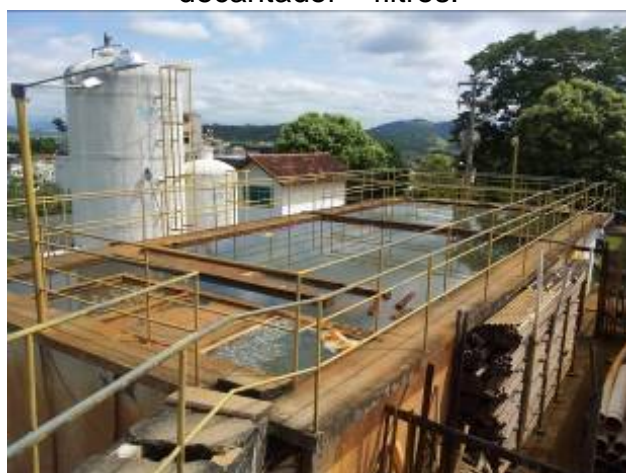
Figura 15 – 1º Conjunto: floculador – decantador – filtros.
