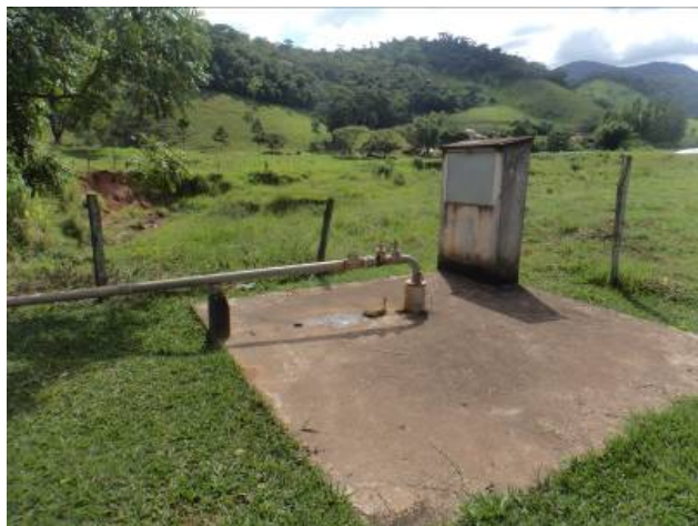
Figura 18- Poço Artesiano que atende o Morro do Estado
