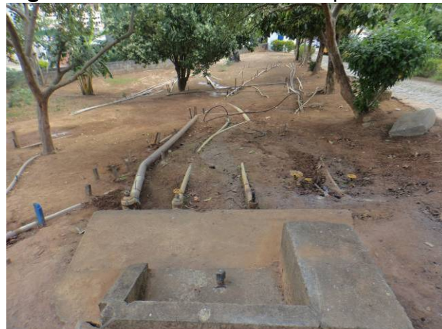
Figura 29 – Adutoras e redes improvisadas.
