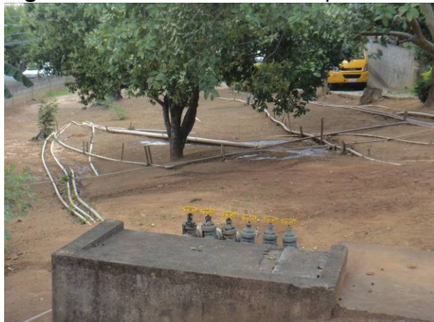
Figura 28 – Adutoras e redes improvisadas.
