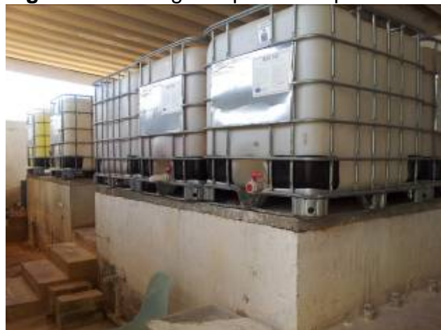
Figura 13 – Abrigo de produtos químicos.
