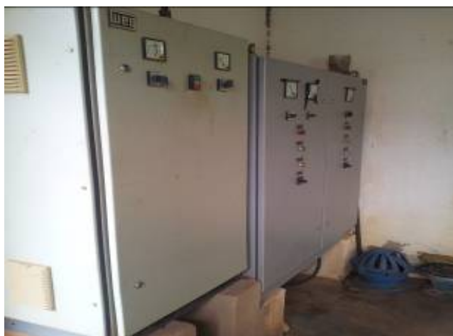
Figura 9 – Quadro de Controle.
