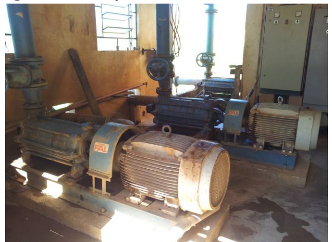
Figura 8 – Estação Elevatória - bombas
