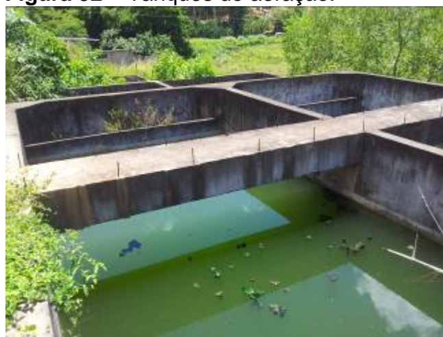
Figura 52 – Tanques de aeração.
