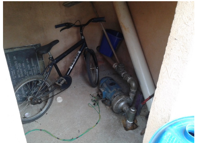
Figura 13 – Casa de bomba da ETA São Sebastião.
