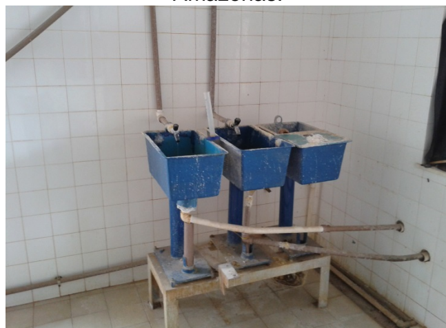
Figura 17 – Misturadores Químicos da ETA Amazonas.
