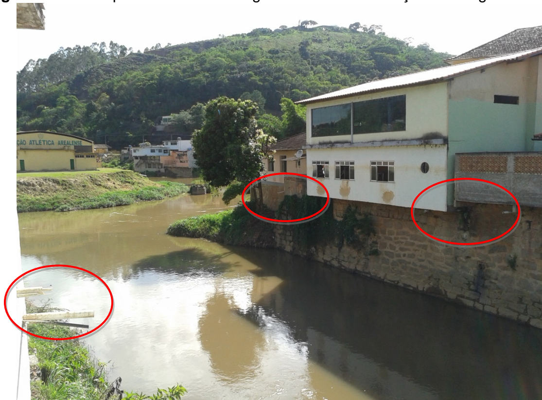
Figura 26 – Exemplo de casas as margens do Rio Preto lançando o esgoto in natura .
