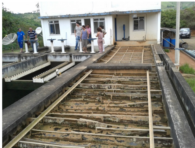
Figura 15 – Flocculadores da ETA Amazonas.
