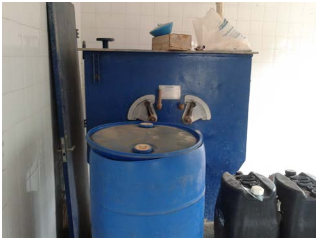
Figura 18 – Armazenamento de cloro na ETA Amazonas.
