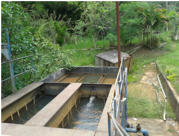
Figura 12 – Decantadores da ETA São Sebastião
