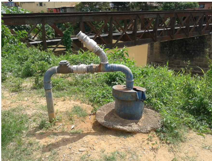
Figura 9 – Poço Artesiano – localizado em frente à Prefeitura.
