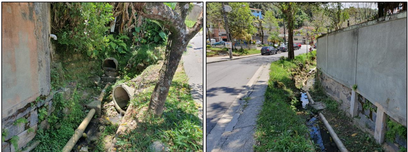
Figura 25 - Drenagem na Vila Luís Macedo, no Bairro Saldanha Marinho Fonte: Vistoria realizada em 06/11/2024
