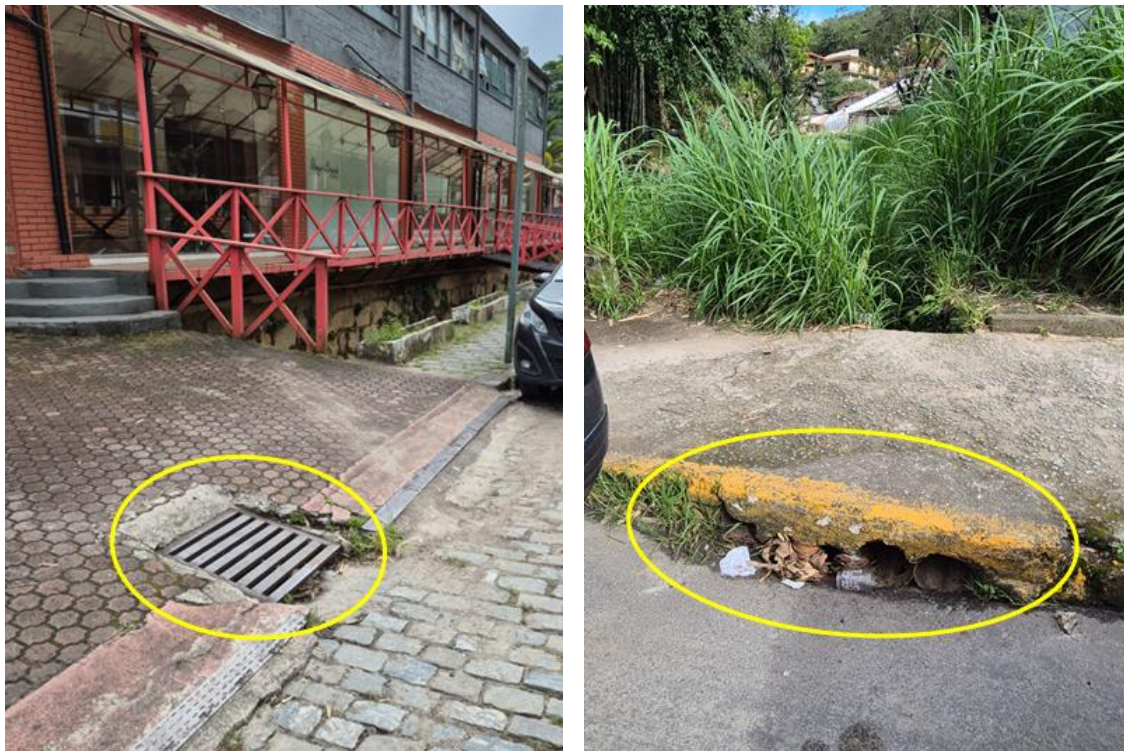
Figura 21 - Dispositivos de microdrenagem em Bingen Fonte: Vistoria realizada em 12/12/2024
