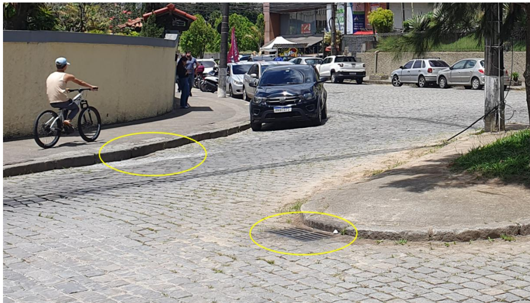
Figura 15 - Dispositivos de microdrenagem (bocas de lobo) no bairro do Quitandinha Fonte: Vistoria realizada em 06/11/2024
