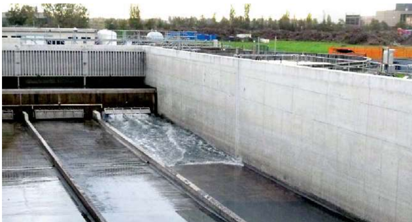
Figura 147 Reservatório de água de primeira chuva com sistema hidráulico automático de remoção de sedimentos em Milão, Itália.
