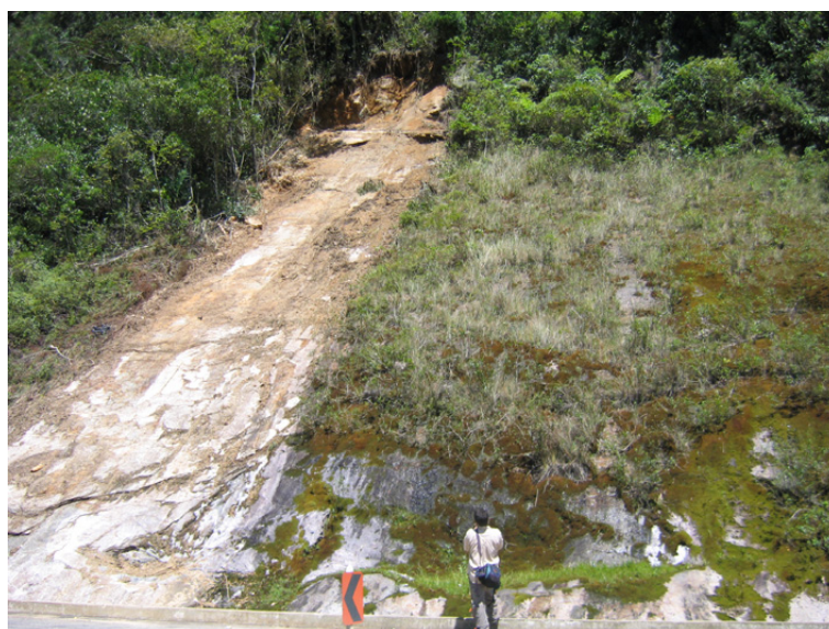
Figura 24 – Escorregamento às margens da rodovia BR-116. Além do plano de escorregamento atual é possível observar a direita da foto uma área em estágio de recuperação da cobertura vegetal sobre uma antigo escorregamento (Escorregamento ocorrido em Dezembro de 2005).
