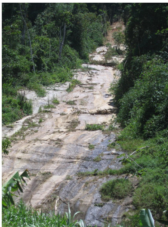
Figura 22 - Escorregamento onde é possível observar que o plano de escorregamento é a interface solo/rocha. Deslizamento ocorrido em Janeiro de 2005 no Bairro Albuquerque.
