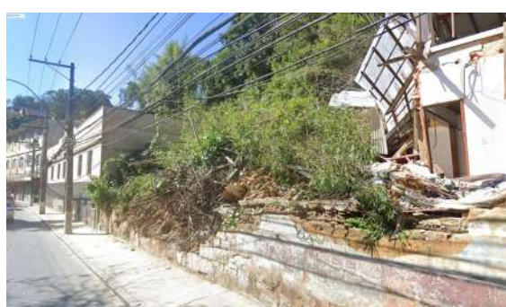
Figura 132: Vazio Urbano (Deslizamento de massa).
