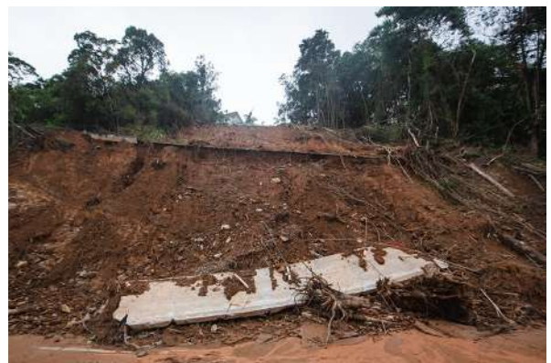
Figura 78: Muro extenso após dia 15/02/2022.
