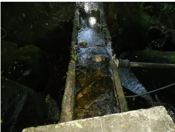
Figura 27 – Captação do córrego Britador
