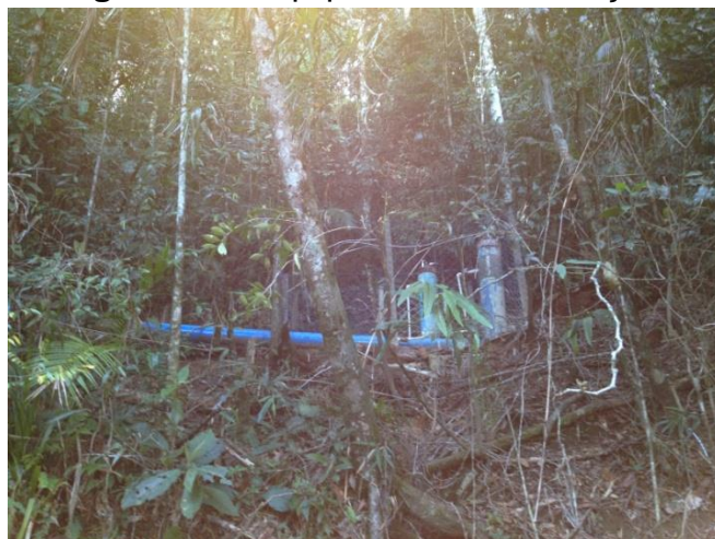
Figura 36 – Equipamento de Cloração.
