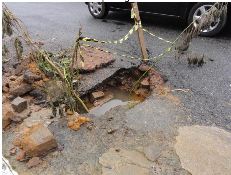
Figura 130 – Asfalto cedendo devido à vazão de escoamento – rua Professor Doutor Amaral – Parque Ingá.
