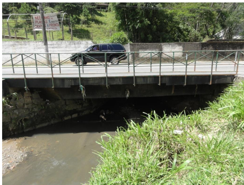
Figura 120 - Trecho de alagamento na rua Tenente Luiz Meireles – São Pedro.
