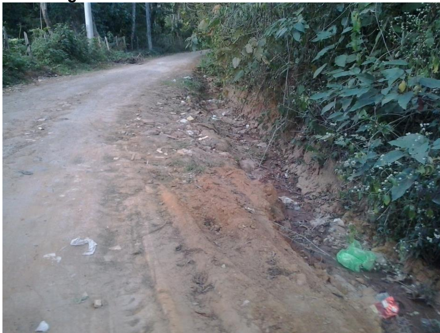
Figura 137 – Processo erosivo no bairro Fischer.
