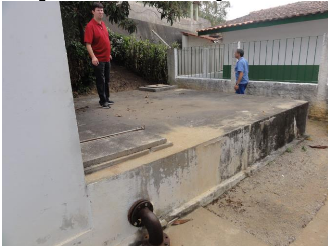
Figura 81 – Elevatória Vargem Grande.
