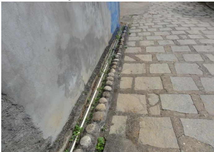
Figura 60 – Rede de Abastecimento na rua Ana Leal Rodrigues.
