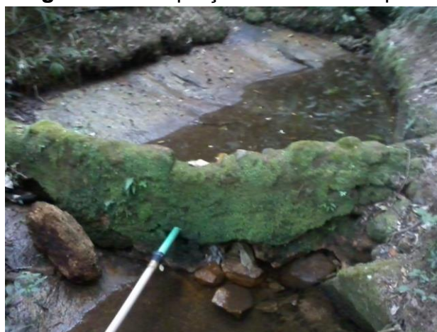
Figura 57 – Captação Fazenda Suspiro.
