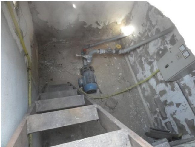
Figura 44 – Elevatória Parque do Ingá.
