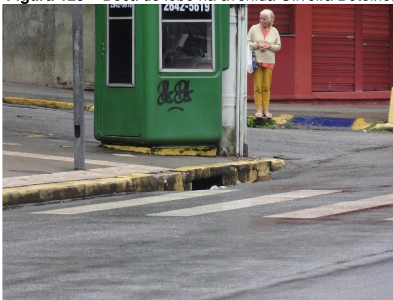
Figura 125 – Boca de lobo na avenida Oliveira Botelho.
