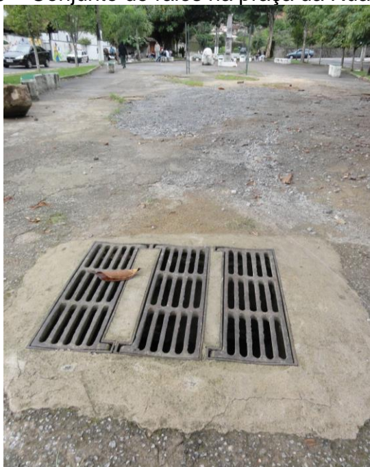
Figura 126 – Conjunto de ralos na praça da Rua Amazonas.
