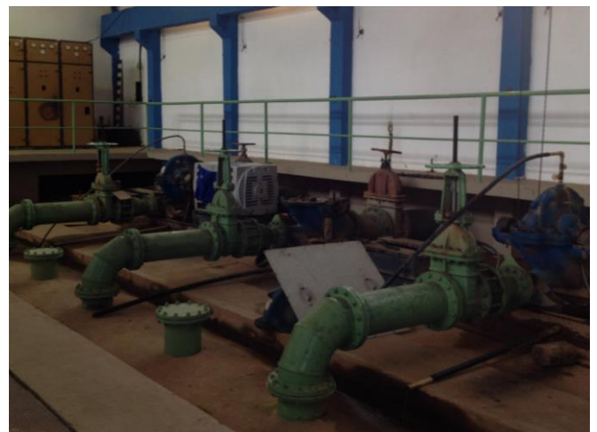
Figura 11 –Estação Elevatória de Água Bruta.
