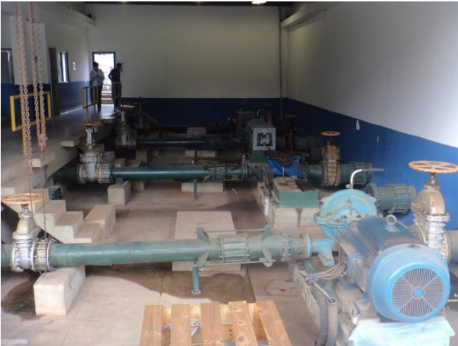
Figura 21 – Estação Elevatória de Água Tratada.
