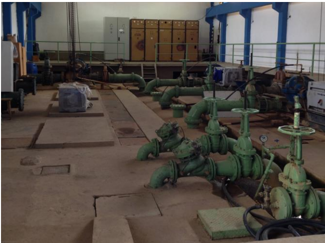
Figura 10 –Estação Elevatória de Água Bruta.
