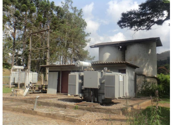
Figura 9 – Subestação da EEAB.
