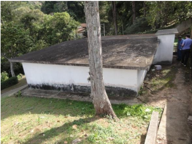
Figura 51 – Reservatório Parque do Ingá.
