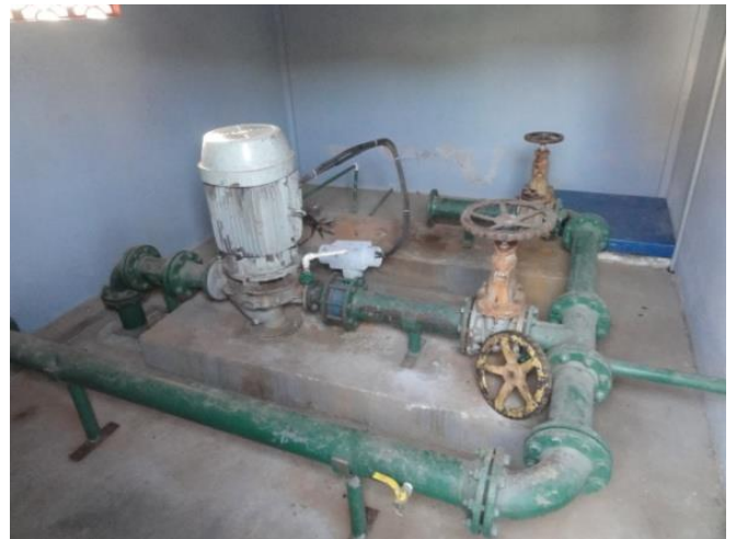
Figura 45 – Elevatória Vale da Revolta.
