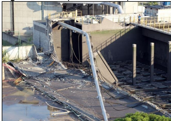
Figura 42 – Rompimento de tanque na ETE.
