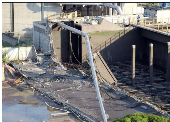
Figura 19 – Rompimento da ETE.
